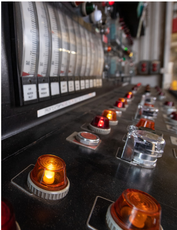
Die parallele Positionierung von Heizkesselsteuerungen kann 5 % bis 7 % des Brennstoffverbrauchs einsparen.
