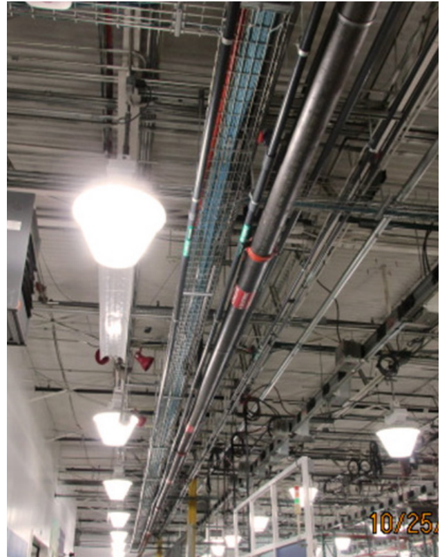
Évaluation de l'éclairage actuel à l'aide d'un inventaire du système d'éclairage.
